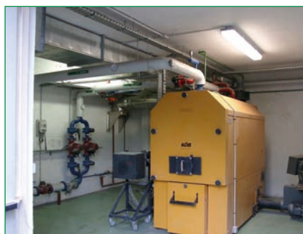
Chaudière à bois de la Maison du Parc à Saint-Brisson (58) ▼
